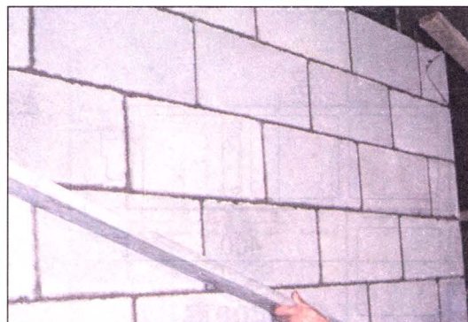
灰缝小, 墙平整
